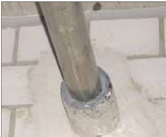
A Unbeschichtete asbesthaltige kaschierte Isolierung im Mauerdurchgang
